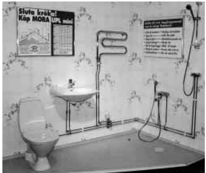
Aus Versicherungsgründen liegen Schwedens Leitungen auf der Wand. Sie werden – weitgehend vorgefertigt – in verchromter Ausführung geliefert
