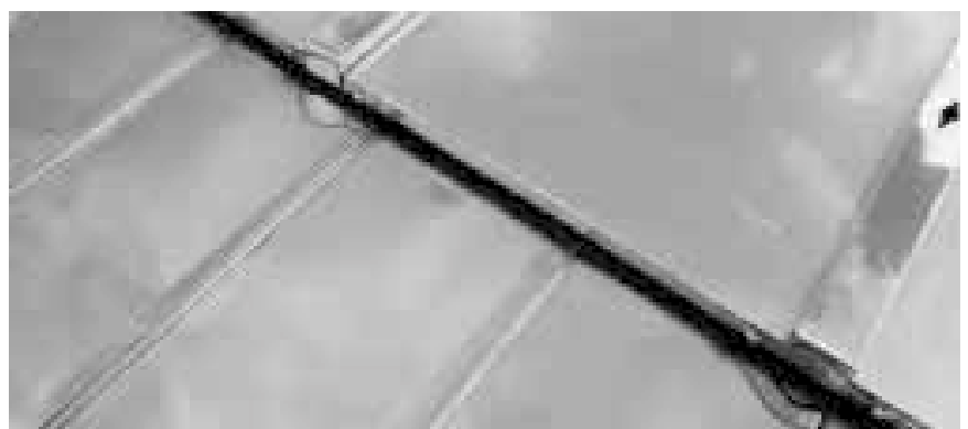
Während die Edelstahl-Scharen (unten links) rollnahtgeschweißt wurden, sind die mit Kranösen bestückten Wartungslukendeckel (oben rechts) mit Abdeckleisten am Baukörper festgeschraubt [2]
