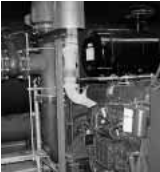
Die Sprinklerpumpen eines Möbelhochlagers arbeiten stromunabhängig, angetrieben durch Lkw-Motoren von je 220 kW [3]
