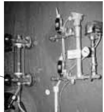
Die Armaturen des Druckbehälters zeigen die korrekte Wasserfüllung und einen Preßluftdruck von 10 bar an [3]
