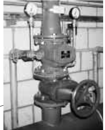
Die NAV-Station aktiviert die Sprinklerpumpen und den Feueralarm [3]
