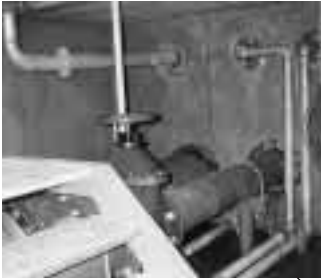
Für die Löschwasserversorgung des Hochlagers sind unterirdische Sammelbecken angelegt [3]
