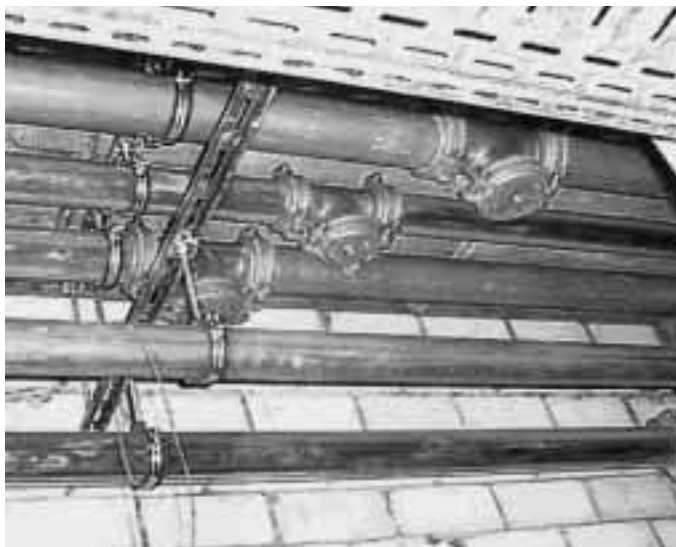
Im Objektbereich findet das Rohrkupplungssystem eine breitgefächerte Anwendung
