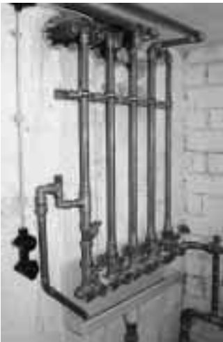
Der Kaltwasserverteiler ist mit dem Preßverbindungssystem „Profi-press“ von Viega erstellt
