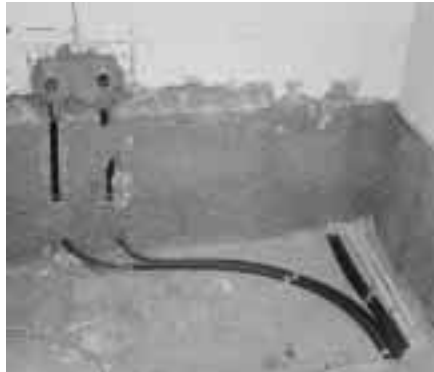
Die Stichleitungen zu Badewanne und Küchenspüle entstammen dem „Sanfix“-System
