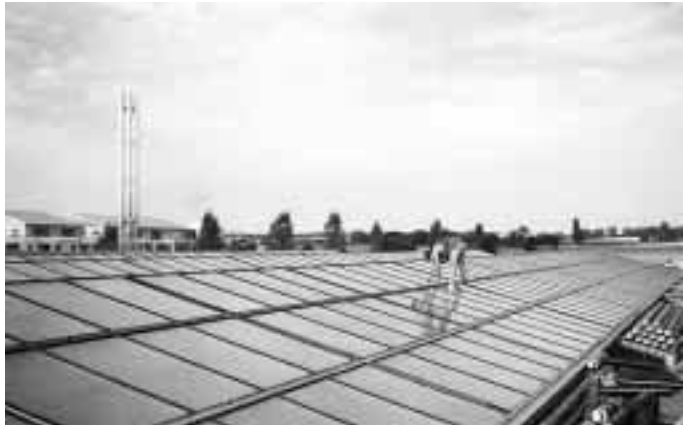
Im Neubaugebiet von Amorbach sind bereits über 1300 von dereinst 15 000 m 2 Kollektorfläche installiert worden
