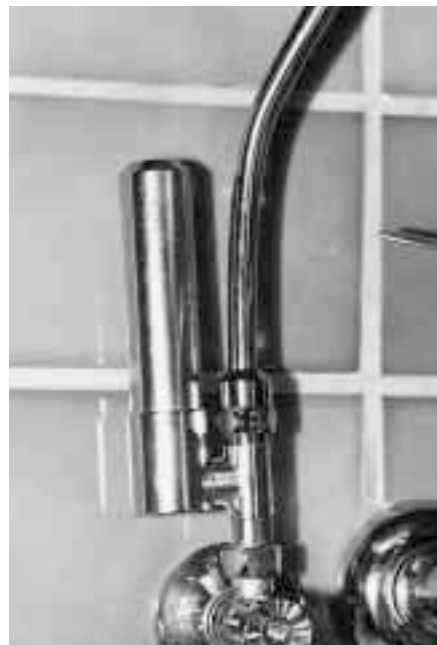
Der unter dem Waschtisch am Eckventil montierte etwa 120 mm hohe Druckschlagdämpfer wirkt kaum störend
