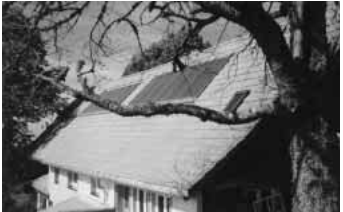
Mit der kombinierten Solar-Luft- und Photovoltaik-Kollektor-Anlage werden die Sanitärräume der Hütte des Deutschen Alpenvereins, Sektion Freiburg, weitgehend frostfrei gehalten
