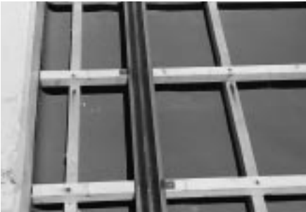
Erster Schritt der Montage ist die Befestigung der mit Auflagestreifen versehenen Aluminiumprofile auf der Holzlattung [4]
