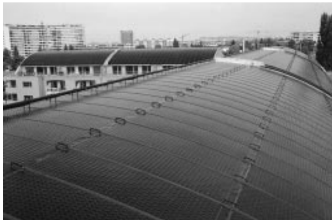
Dachbekleidung und Warmwasserkollektor zugleich ist das Solardach von Solaire [4]
