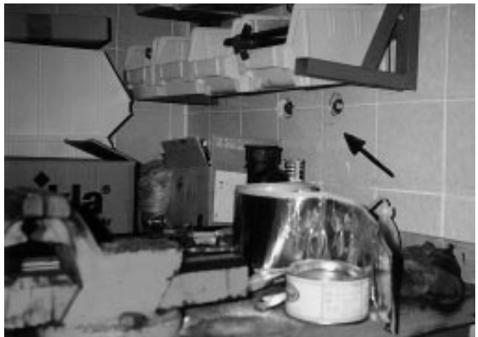
Gefahr durch Nutzungsänderung: Erst Waschraum, jetzt Werkstatt – und hinter den Stopfen ‚fault‘ das Wasser
