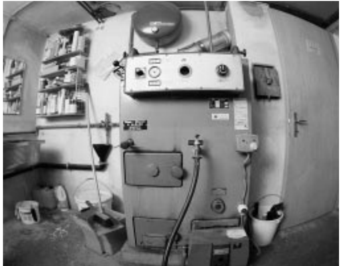
Nach 25 Jahren war der alte Kombi-Ölkessel von Müller Eigenheim durchgerostet
