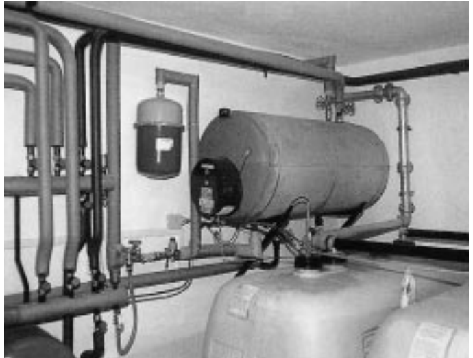
Unzulässige Anordnung von Warmwasserbereiter, Ausdehnungsgefäß und wasserführenden Leitungen oberhalb der Auffangwanne von Heizöl
