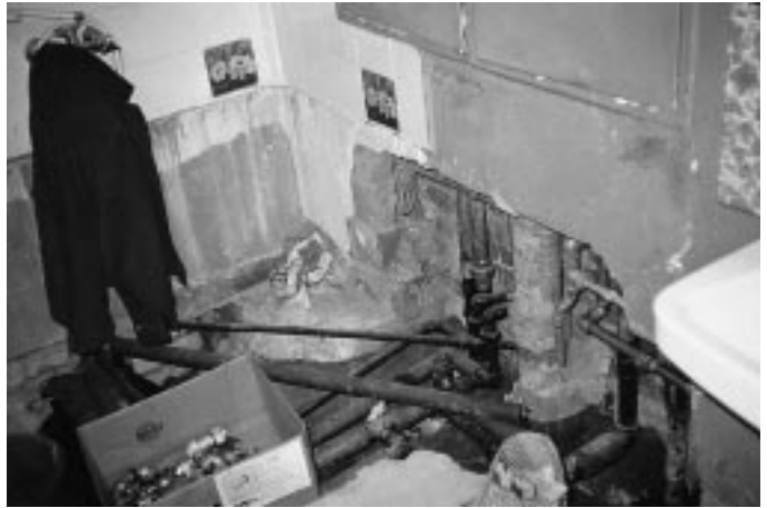
Nicht selten soll der Rohrbruch hinter der Badewanne zur Badsanierung auf Rechnung des Versicherers werden [2]
