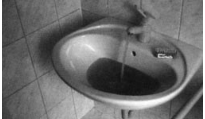
Das Wasser eines Wohn- und Geschäftshauses zeigte eine starke Braunfärbung, die auf Korrosion von Eisen hinwies
