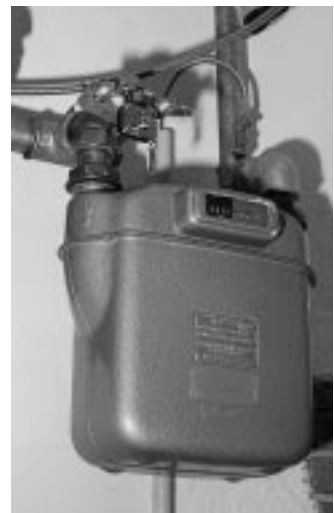
Die „Parkkrallen für die Gasleitung“: Eine Gas-hahnsicherung verhindert im Normalfall, das der Absperrhahn während der Arbeiten geöffnet wird [9]
