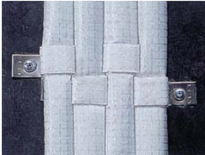
Die Verwendung von Kompakt-Dämmhülsen einschließlich schallentkoppelter Halter gewährleistet eine schallsichere Verlegung von Rohrleitungen
