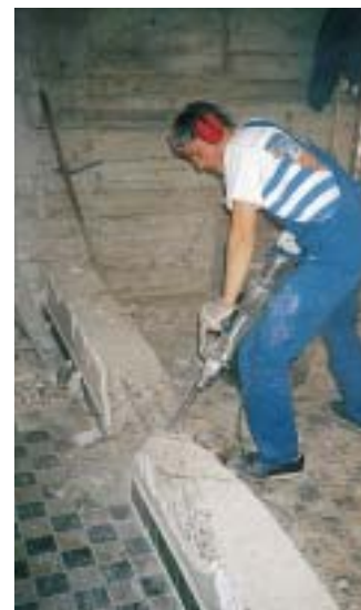
. . . auch die Gas- und Wasserinstallateure waren eifrig zu Gange, besonders beim Abbau des Überzugs, der am Fuß der Wand zutage trat . . .
