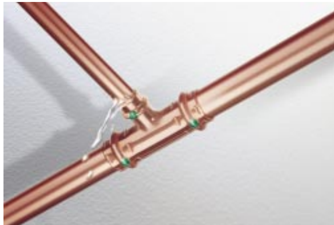
Austretendes Wasser durch die Sicherheitskontur SC (grüne Markierung) und Druckabfall führen auf die Spur unverpresster Verbindungen
