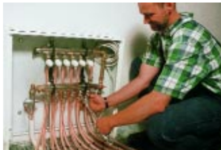
Rund 700 Heizkreisverteiler wurden in der Hamburger Wohnanlage installiert
