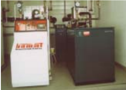
Die Abgaswärme-Rückgewinnung ist auch bei Klein-Blockheizkraftwerken (rechts im Bild) sinnvoll
