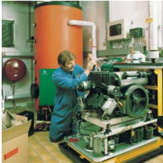
Mit einem BHKW sorgt der Heizungsbauer nicht nur für Wärme, sondern auch für den Strom im Haus [1]
