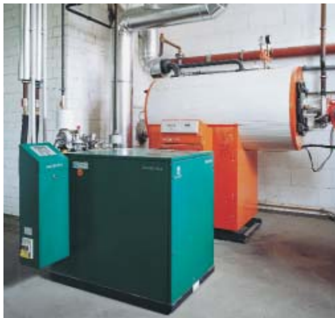
Um die Rückspeisung von Strom möglichst gering zu halten, werden in Wohngebäuden häufig zusätzlich zum BHKW Spitzenlastkessel installiert [1]
