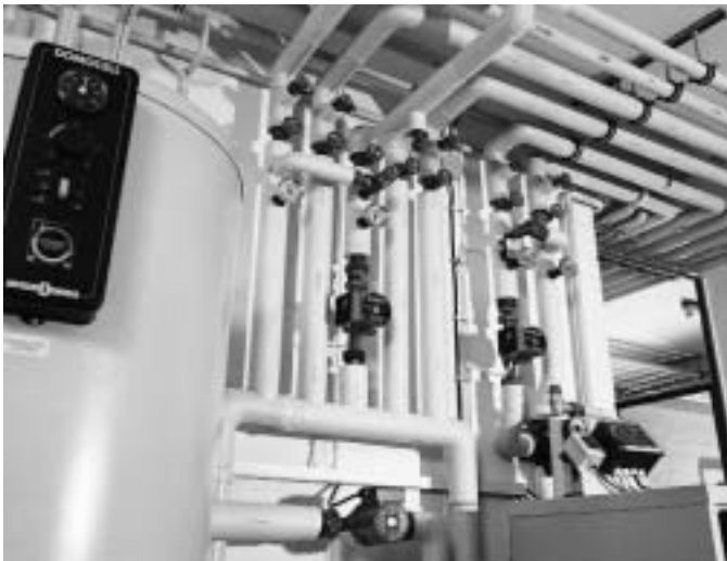
Damit es später keine Probleme gibt, ist der hydraulische Abgleich unabdingbar
