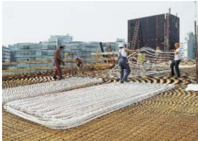
Nachdem die Velta-Contec-Bewehrung verlegt wurde, erfolgt die Verteilung und Ausrichtung der Module
