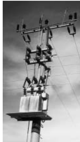
Der Sternpunkt auf der Niederspannungsseite der Trafostation wird geerdet und als Mittelleiter (4. Leitung) weitergeschickt
