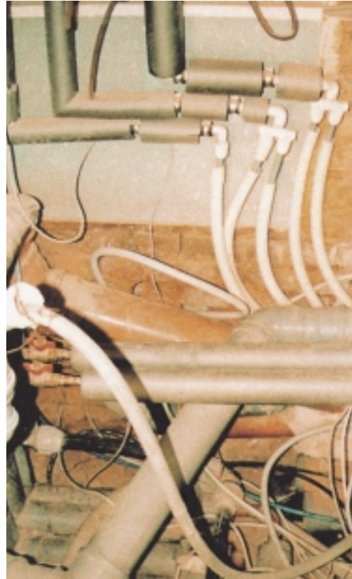
. . . der durfte sich bei einem Blick auf die Installation im Abstellraum eines Besseren belehren lassen
