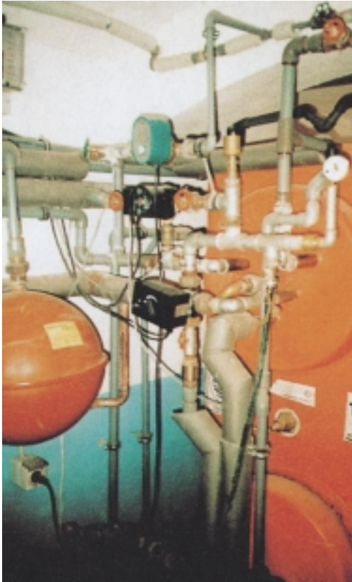
Wer glaubte, die chaotische Leitungsführung im Heizkesselbereich sei durch nichts zu toppen . . .
