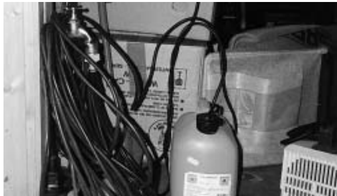
Eine „vergessene“ Entnahmearmatur begünstigt Stagnation
