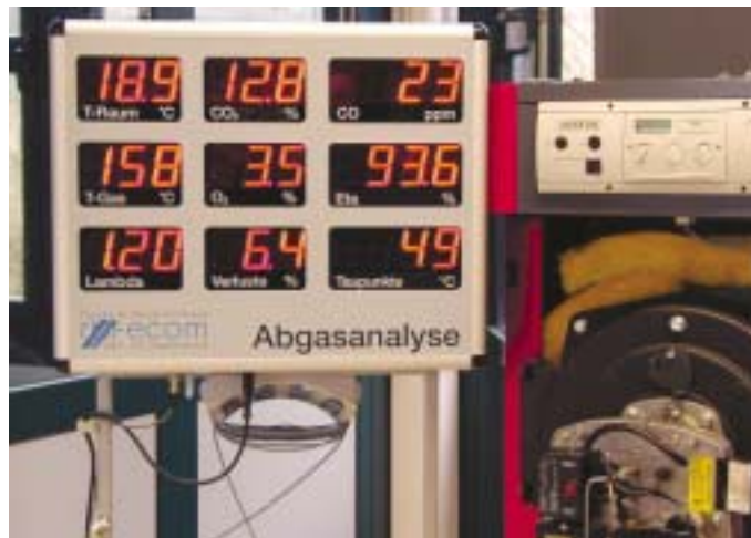
Die Durchführung von Abgas-, CO-, und Rußmessung gibt Aufschluss darüber, ob die Wartung erfolgreich war
