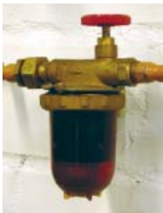
Bestandteil einer Wartung ist es auch, einen verschmutzten Ölfilter zu reinigen
