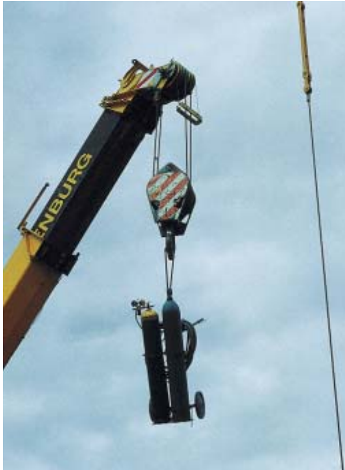
Diebstahlsicher, aber unzulässig: Azetylen- und Sauerstoffflasche am Kran
