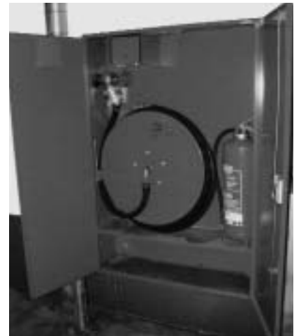
Bereit für den inneren Löschangriff: Wandhydranten liefern der Feuerwehr im Gebäude das Wasser
