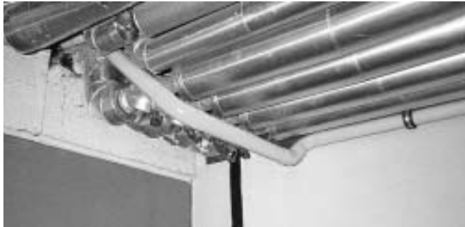
Tunnelblick: Die brandsicherste Befestigung ist sinnlos, wenn im Brandfall andere Leitungen auf die Gasleitung stürzen
