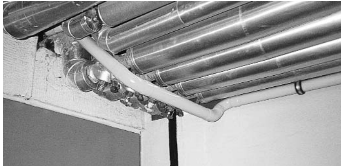
Tunnelblick: Die brandsicherste Befestigung ist sinnlos, wenn im Brandfall andere Leitungen auf die Gasleitung stürzen
