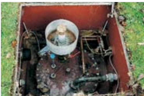
Ein Blick in den Domschacht eines Heizöl-Erdtanks: Hier sitzt nicht nur der Füllstutzen ...
