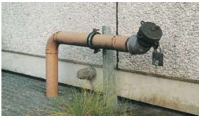
Bei Kellertanks wird der Einfüllstutzen und der Grenzwertgeber-Anschluss bis an eine gut zugängliche Stelle geführt
