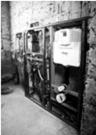
Da auch der Materialbedarf vom Rechner ermittelt wird, fehlt vor Ort meist nichts und die Arbeit geht schnell voran
