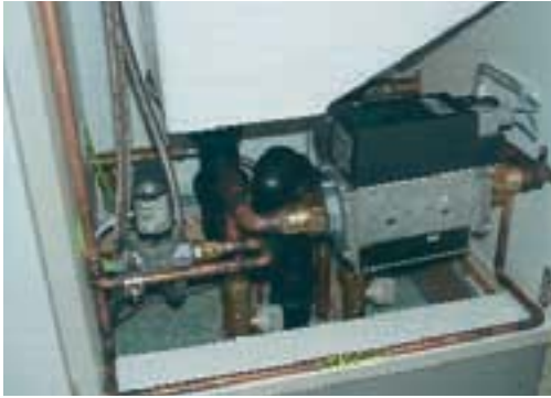
Zwischenabspernung und LSV werden meistens – wie hier – im Lehrertisch untergebracht
