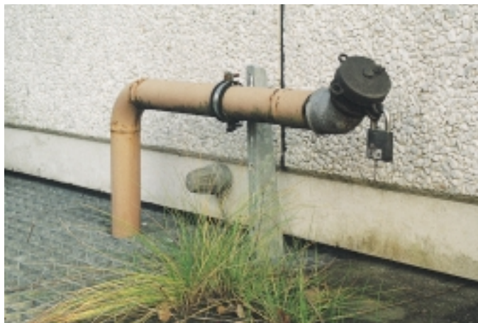
Damit die Anlagen auch den Brennstoff bekommen, den sie vertragen, werden die Einfüllstutzen...
