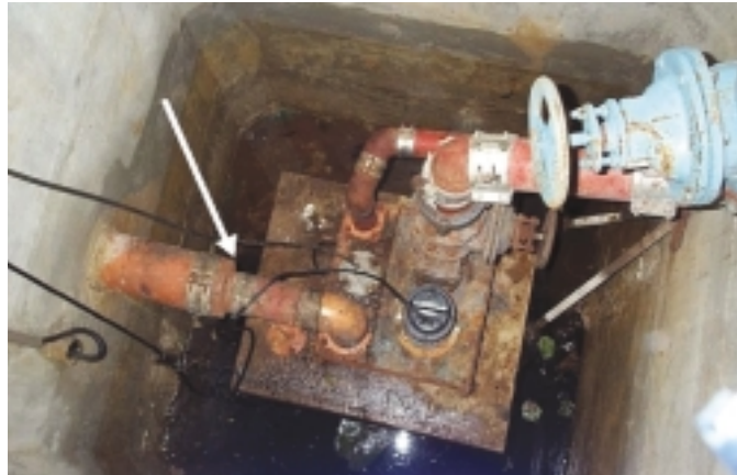
Nicht zulässig, aber oft zu finden: Der Zulauf zur Hebeanlage wird reduziert (Pfeil)
