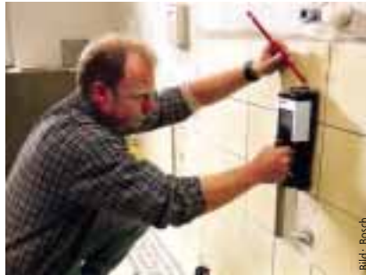
Mit modernen Ortungsgeräten kann man vor dem Bohren buchstäblich in die Wand sehen und so böse Überraschungen vermeiden
