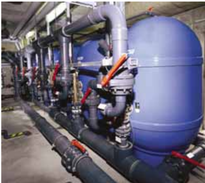
Die Filteranlage ist das Herzstück der Schwimmbad-Wasseraufbereitung
