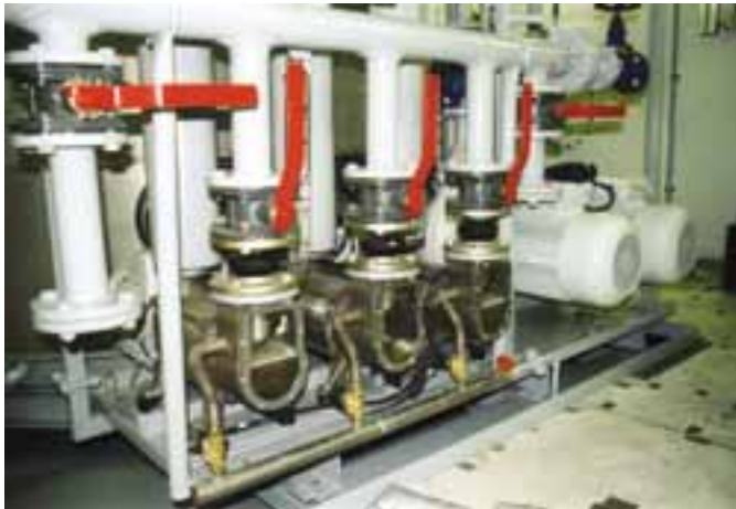
Vier solcher Vakuum-Anlagen sorgen für den Unterdruck im Schwarzwasser-Entwässerungssystem
