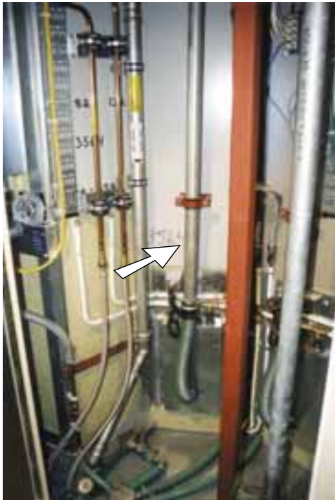
... kann vom Gang des Decks erreicht werden – nicht wundern: der WC-Abfluss führt nach oben weg (Pfeil), denn ...
