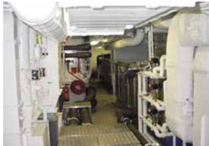
Einer von 31 Klimäräumen an Bord. Stündlich werden hier bis zu drei Millionen Kubikmeter Luft durchgesetzt
