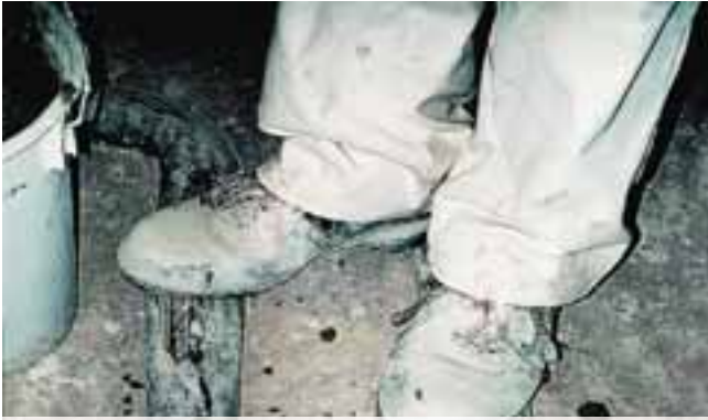
Auf Baustellen wird die Rohrleitungs­dämmung häufig buch­stäblich mit Füßen getreten. Leidet dadurch der Schallschutz, kann das teuer werden. Mehr dazu lest ihr ab Seite 28.
