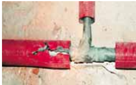
Nicht durchgängig ausgeführte Dämmummantelungen machen den Schallschutz zunichte
