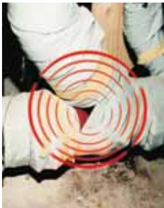
Schon kleine Fehlstellen in der Dämmung können teure Schallbrücken sein
