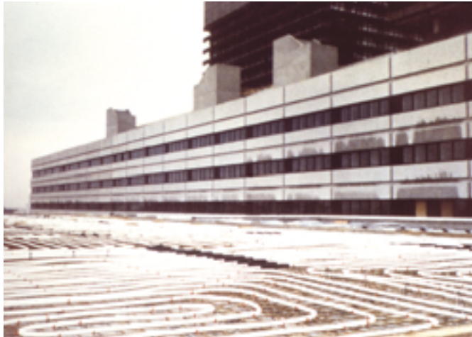
Selbst große Flächen wie der Hubschrauberlandeplatz der Universitätsklinik AKH Wien sind mit Beheizung ausgestattet
