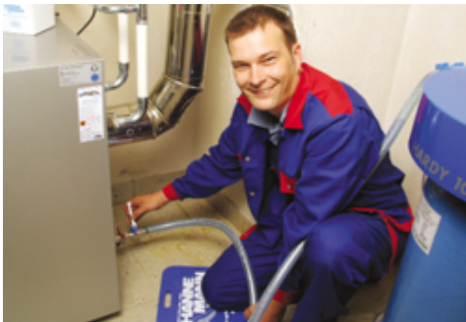
Gleich beim Befüllen wird das Wasser korrekt behandelt...
