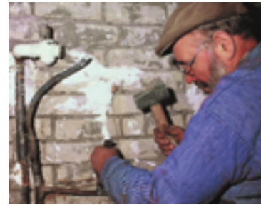
Stößt der Fachmann auf Bleirohre, muss er den Eigentümer informieren, dass diese ausgebaut werden müssen
