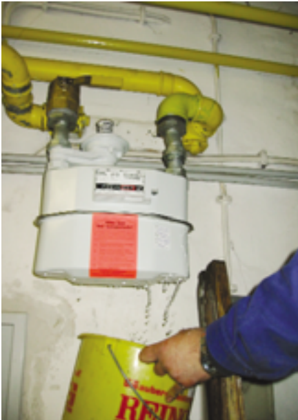
Aus dem Gaszähler strömte Wasser
