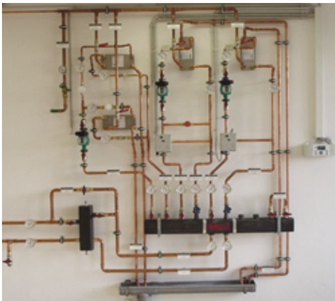
Mit einem statischen Heizkreis (links), einem Fußboden-Heizkreis (Mitte) und einem Mischerkreis ohne feste Vormischung (rechts) sind zahlreiche Versuche durchführbar
