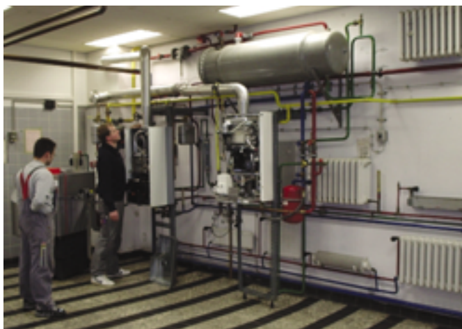
Mit der alten Versuchsanlage konnte die Anlagenhydraulik nur sehr unzureichend simuliert werden
