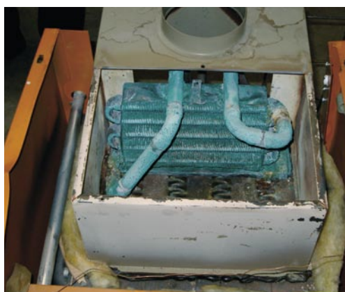
Bild 1: Brennwertanlage erwünscht? Kein Problem: Man bastle einfach den Wärmetauscher aus einer T2 in den Abgasweg des Wolf-Kessels
