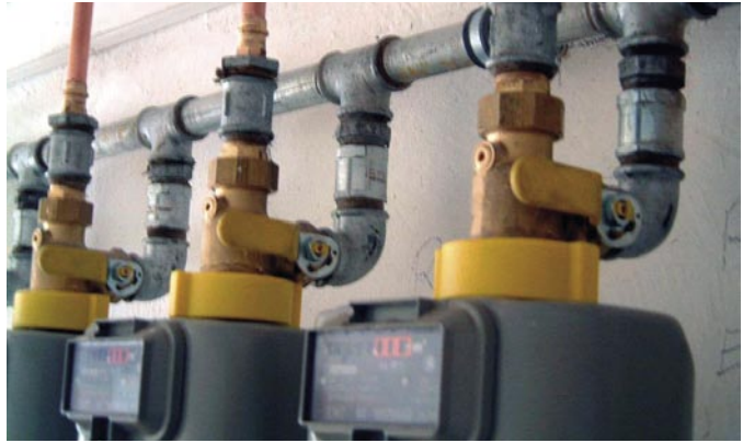
Sind mehrere Leitungen in einem Haus installiert, muss der Profi entscheiden, ob die Lecks addiert werden müssen
