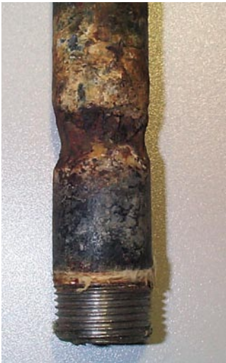
Relikt aus feuchtem Keller: Diese Leitung war sogar noch dicht – aber nicht mehr gebrauchsfähig
