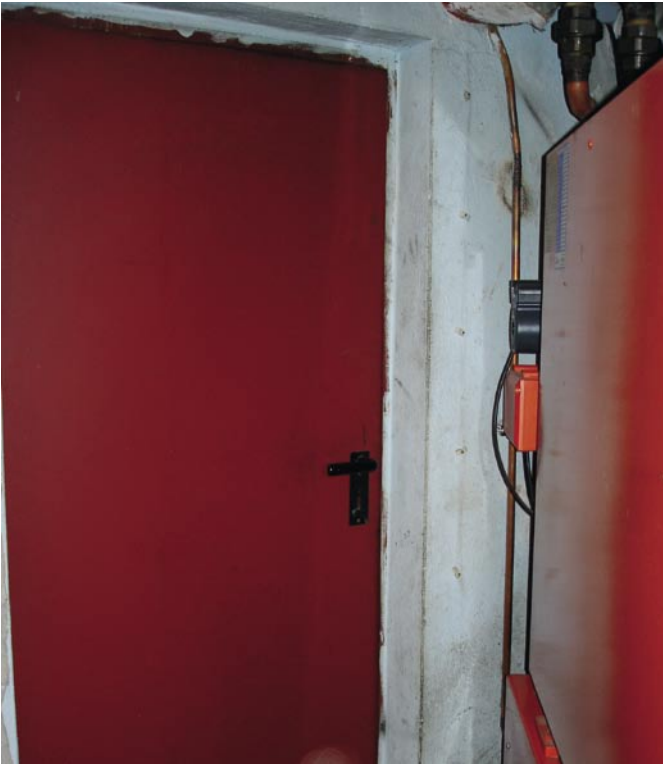
Bei der Öl- und Gasbefuerung hat sie ausgedient, auch wenn die Leistung jenseits der 50 kW liegt: die FH-Tür
