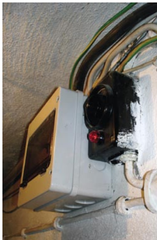
Weiter erforderlich ist und bleibt der „Notschalter Feuerung“
