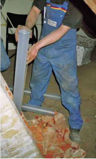
Das Abgasrohr aus Polypropylen wird an den Dachs angeschlossen
